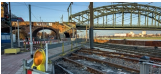
Bahnübergangssicherung Köln Rheinufer
